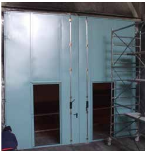
“Due grandi battenti apribili per i mezzi di soccorso e due porte pedonali (via di fuga) con apertura nei due sensi opposti”
